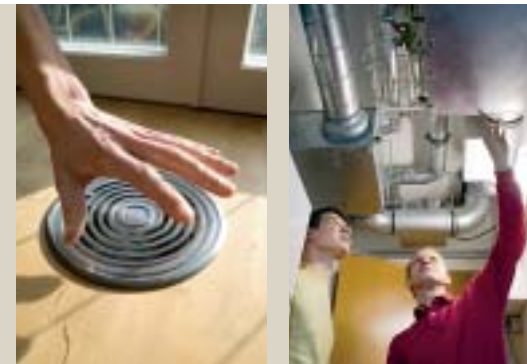
Die Lüftungsanlage bläst Wärme aus dem Boden.
